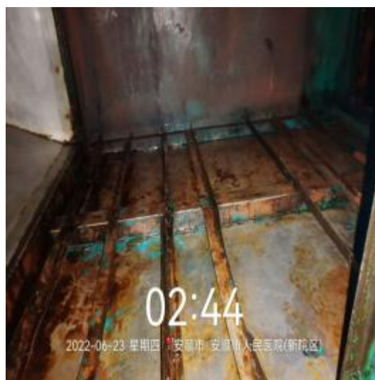
净化器机箱清洗后
