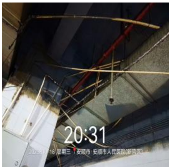
管道线管清洗前
