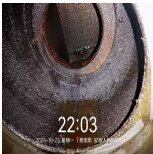
风机机箱清洗前 1
