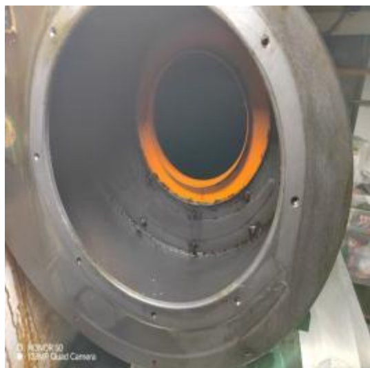
风机机箱清洗后 2
