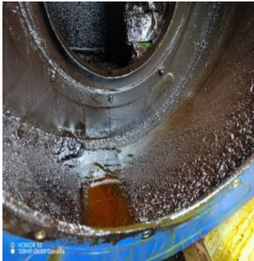
风机机箱清洗前 3
