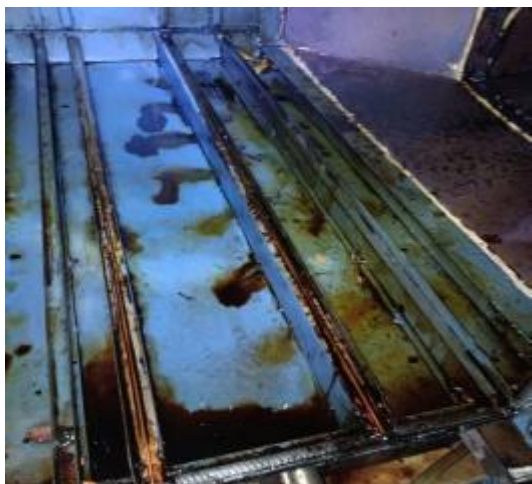
净化器机箱清洗前
