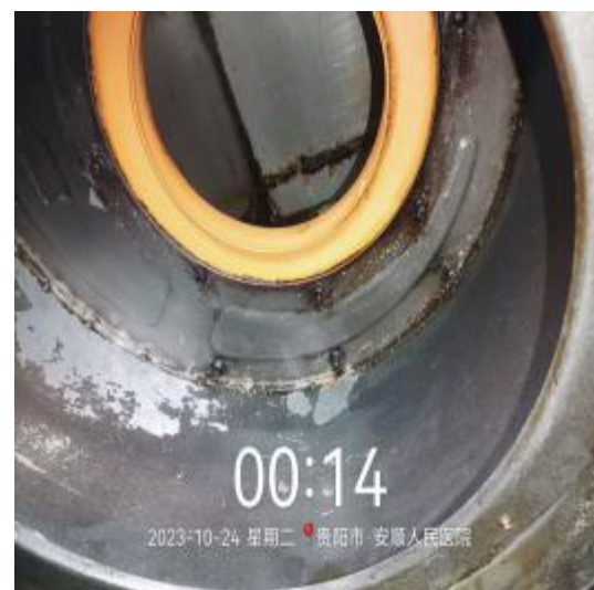
风机机箱清洗后 1
