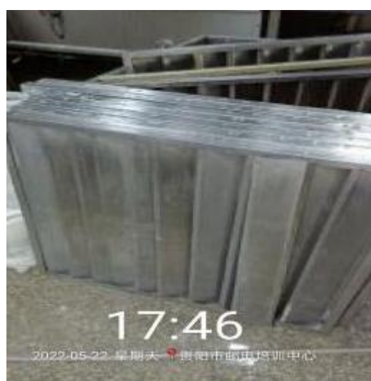
防火板清洗后
