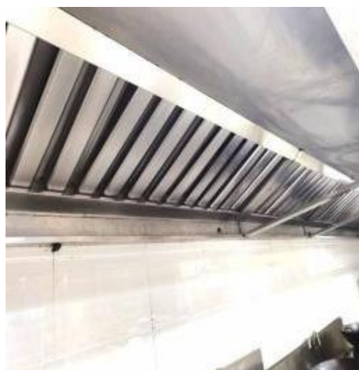
防火板清洗后
