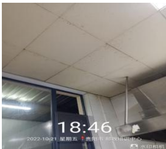
天花板清洗前
