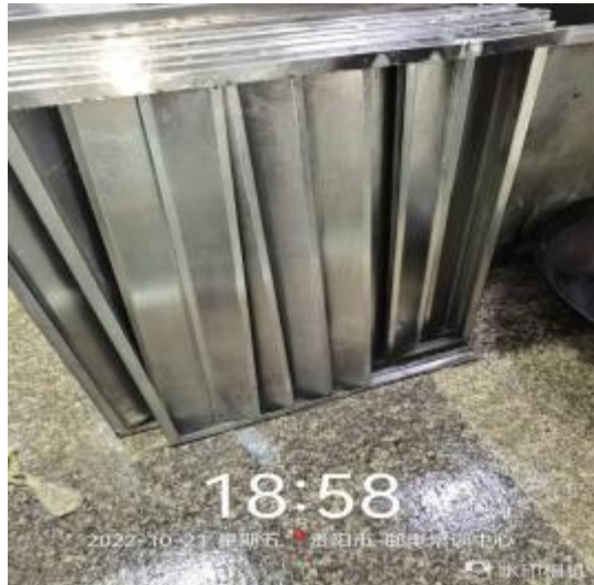
防火板清洗后
