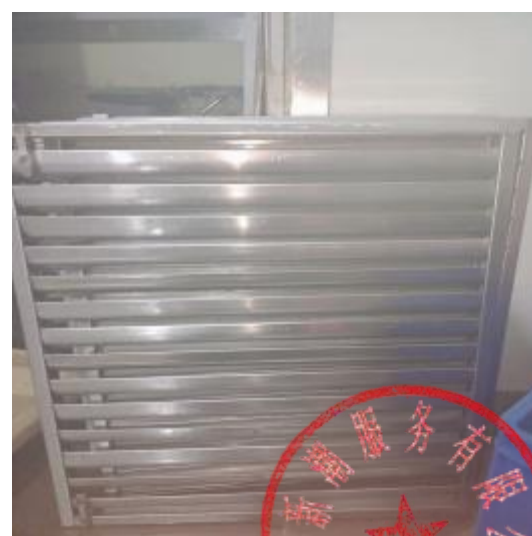
防火板清洗后
