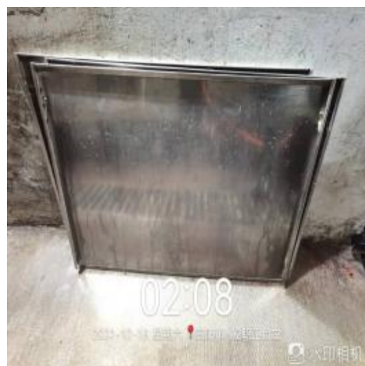
防火板清洗后
