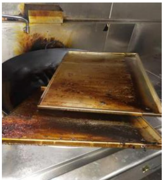
防火板清洗前
