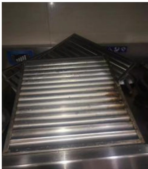
防火板清洗前
