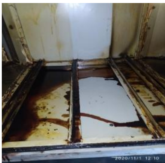
净化器机箱清洗前
