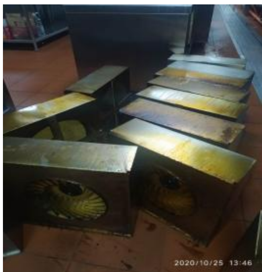
运水风扇清洗前
