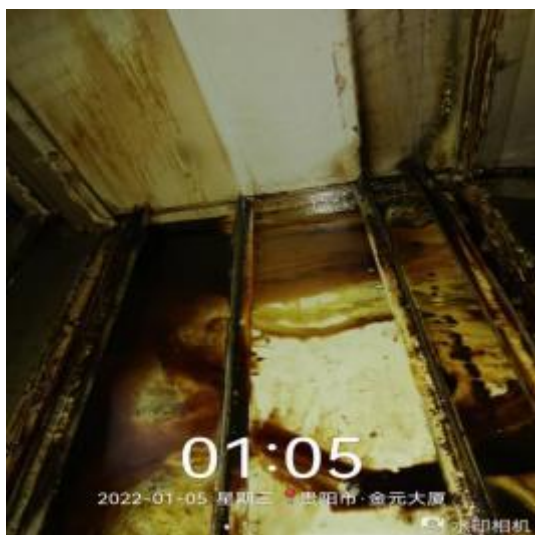
净化器机箱清洗前
