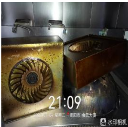
运水风扇清洗前
