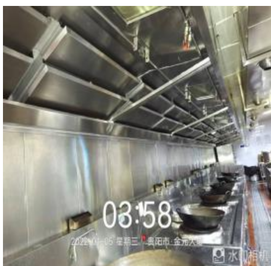
大厨房整体烟罩清洗后
