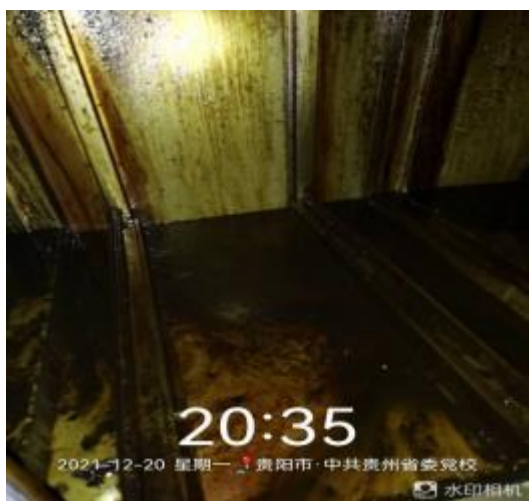
净化器机箱清洗前
