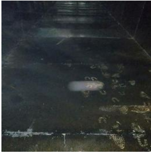
T1T2 主管道清洗前 1
