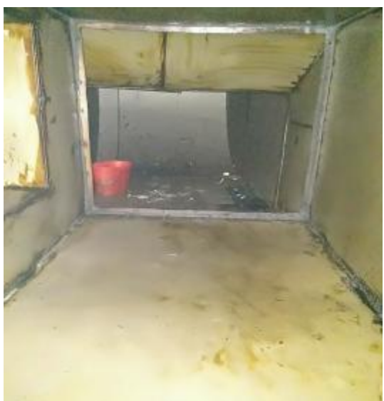
丽港酒店管道清洗前 2
