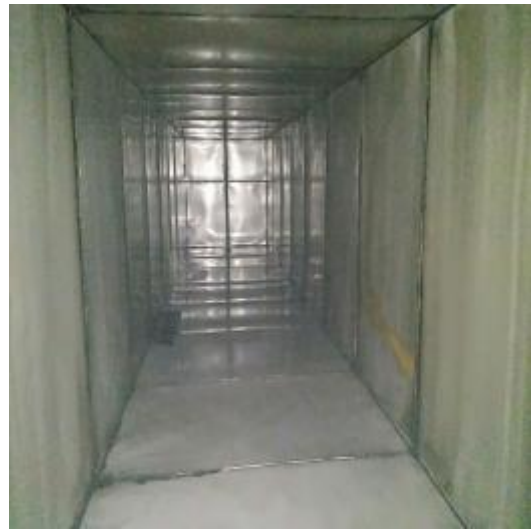
T1T2 主管道清洗后 1
