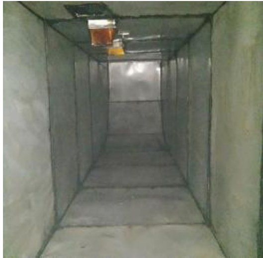
T1T2 主管道清洗后 2
