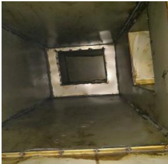
丽港酒店管道清洗前 1
