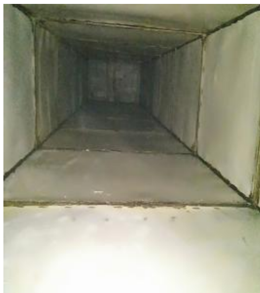
T1T2 主管道清洗后 3
