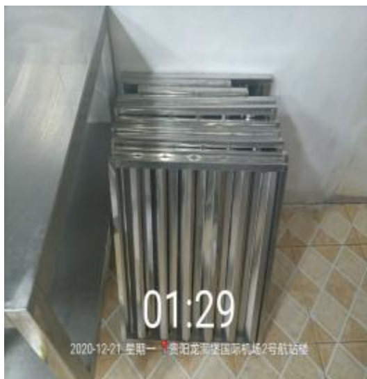
防火板清洗后
