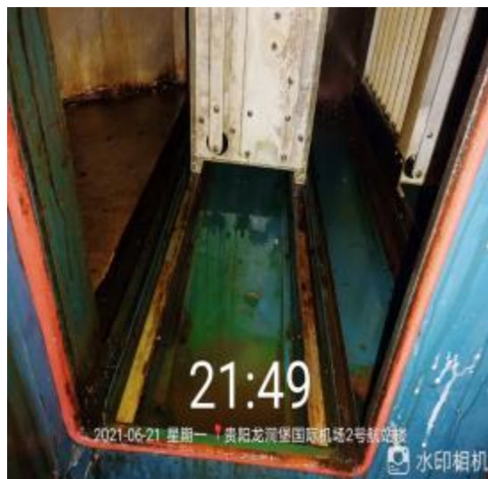
净化器机箱清洗前
