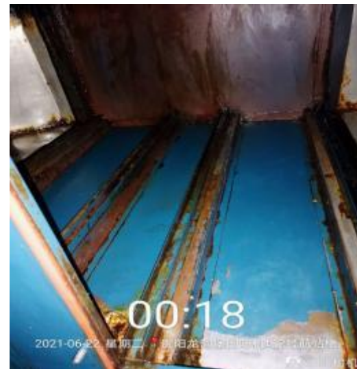
净化器机箱清洗后
