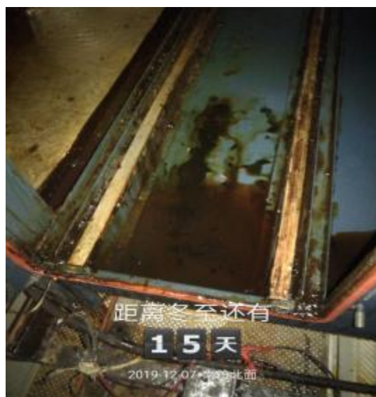
净化器内部清洗前
