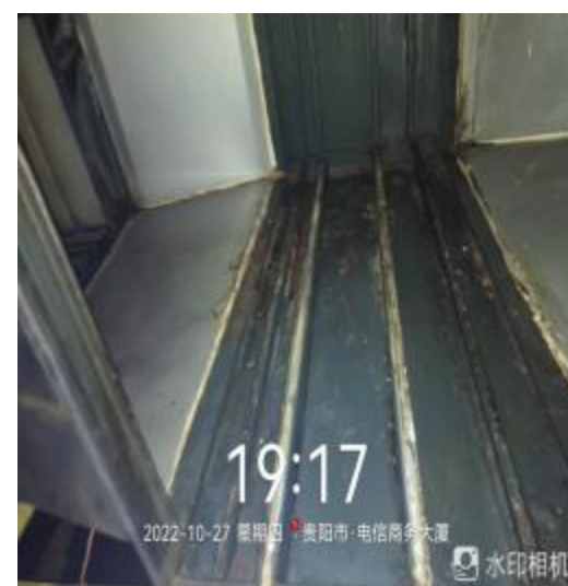
净化器机箱清洗后
