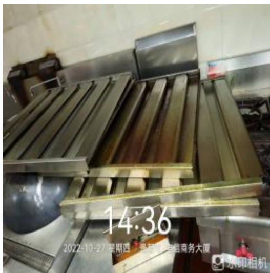
防火板清洗前
