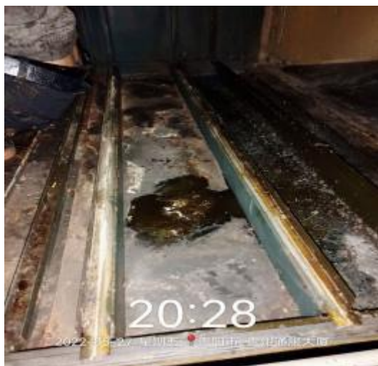
净化器机箱清洗前
