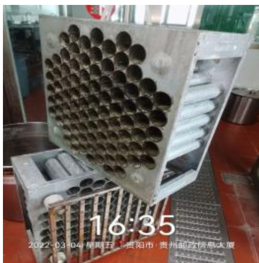
六楼净化器清洗前
