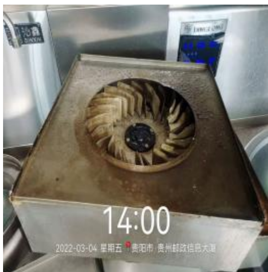
运水风扇清洗前
