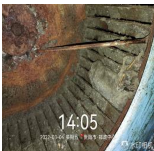
六楼风机清洗前
