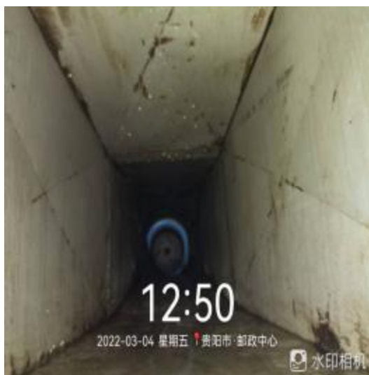
风机管道清洗前
