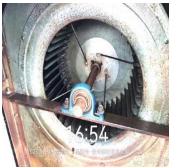
六楼风机清洗后
