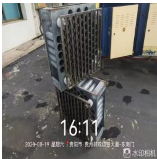
六楼净化器清洗前
