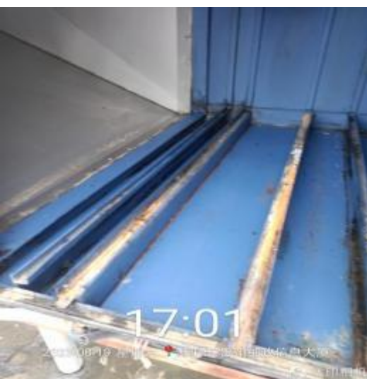
六楼净化器机箱清洗后
