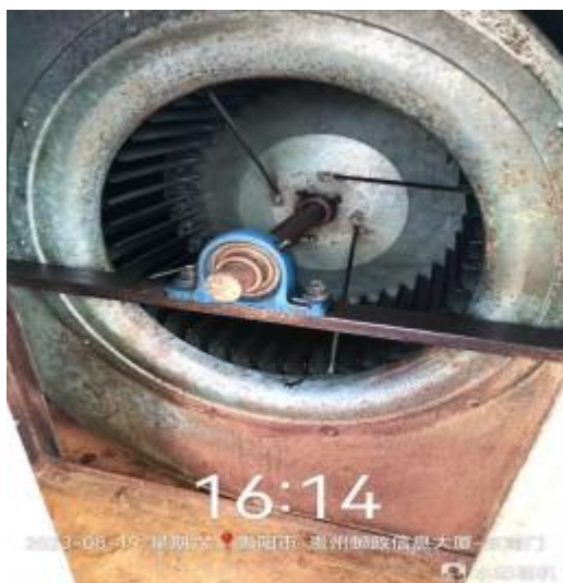
六楼风机清洗前
