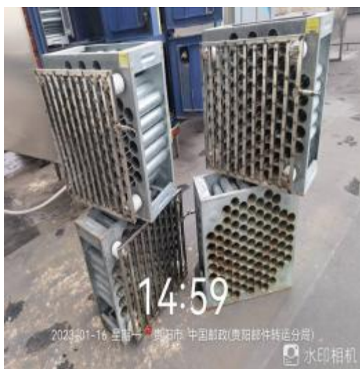
六楼净化器清洗前
