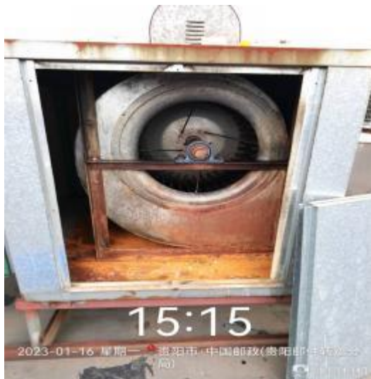
六楼风机清洗前
