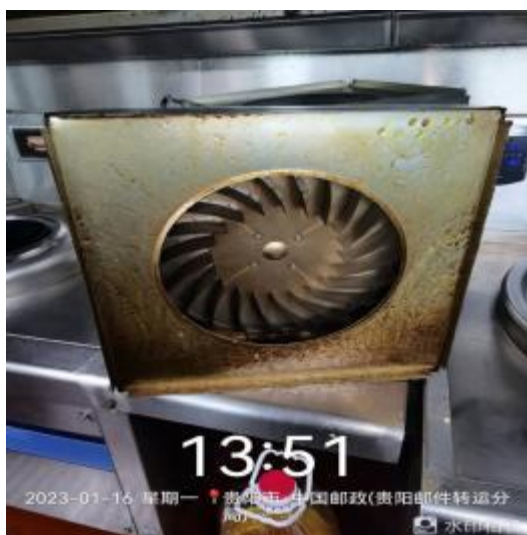
运水风扇清洗前
