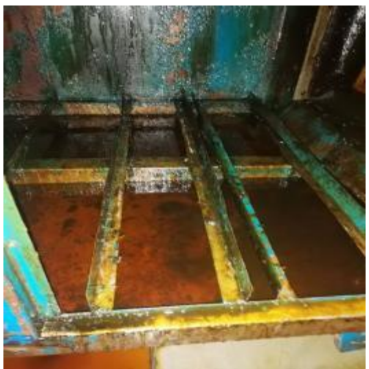
净化器机箱清洗前
