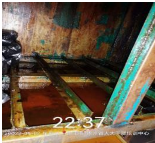
净化器机箱清洗前
