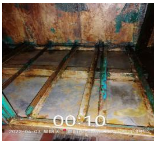
净化器机箱清洗后
