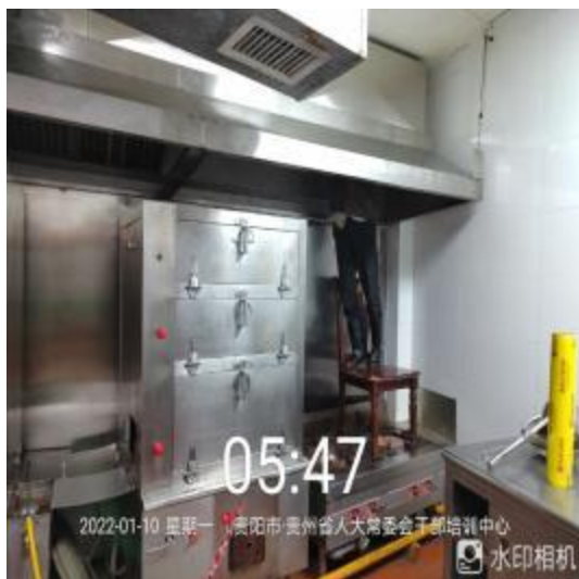
蒸饭柜烟罩清洗中
