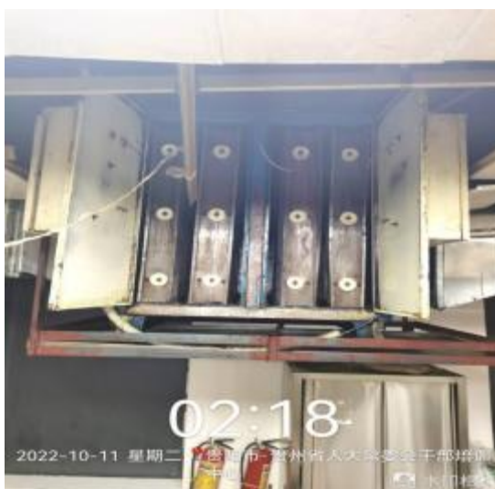
净化器机箱清洗后
