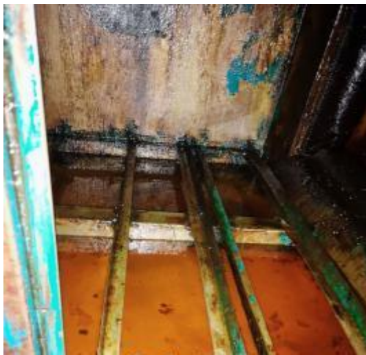
净化器机箱清洗前
