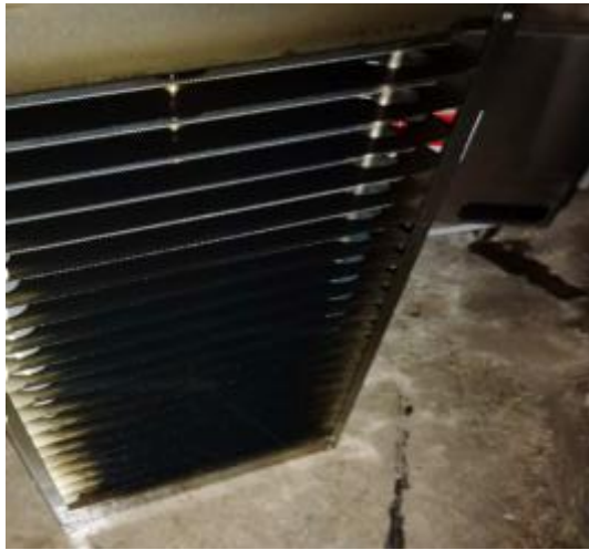
净化器过滤芯清洗前
