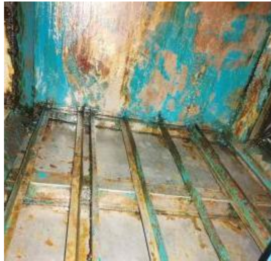
净化器机箱清洗后
