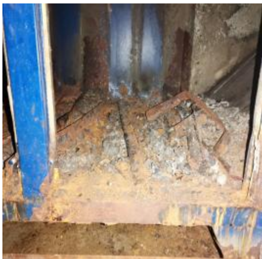
净化器机箱清洗前
