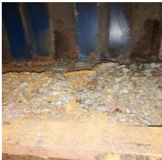
净化器机箱清洗前
