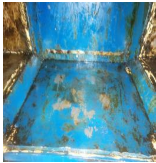
净化器机箱清洗后
