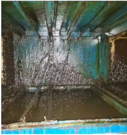
净化器机箱清洗前
