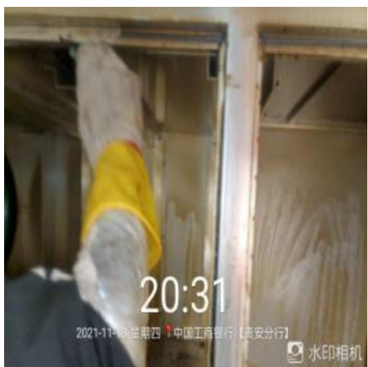
净化器机箱清洗前
