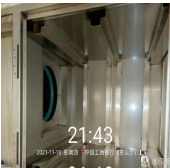
净化器机箱清洗后
